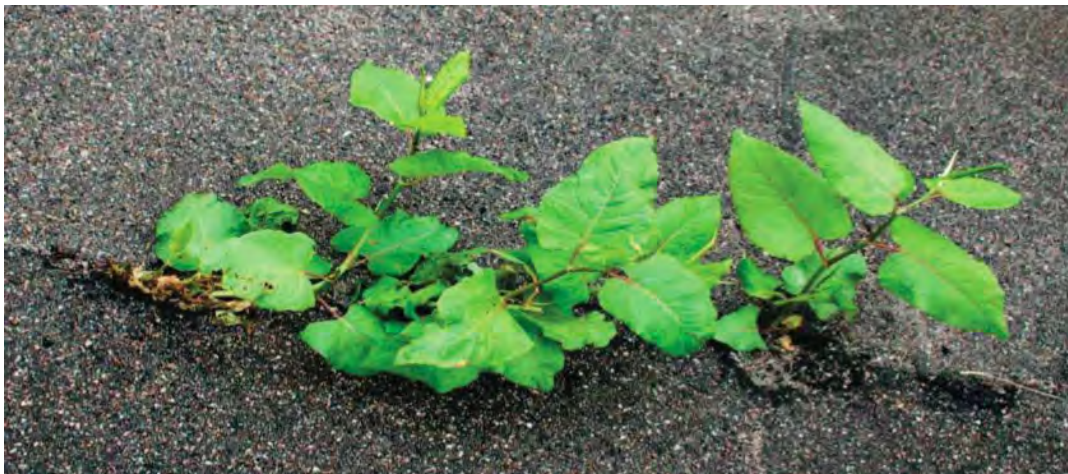
Figure 6 : Une Renouée passant à travers le bitume
