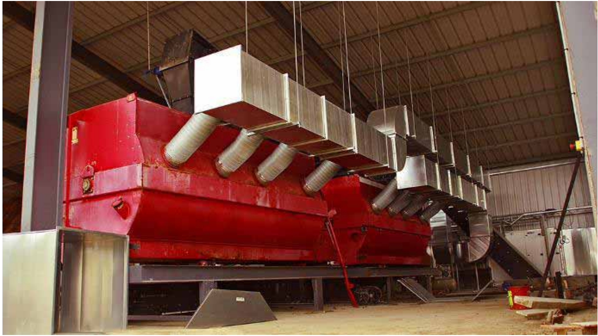
Figure 2 : séchoir à plaquettes de bois du Gaec de Kerollet. [1]
